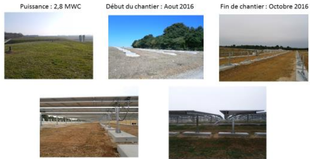
Photo 2 : Parc solaire de Ruffec
