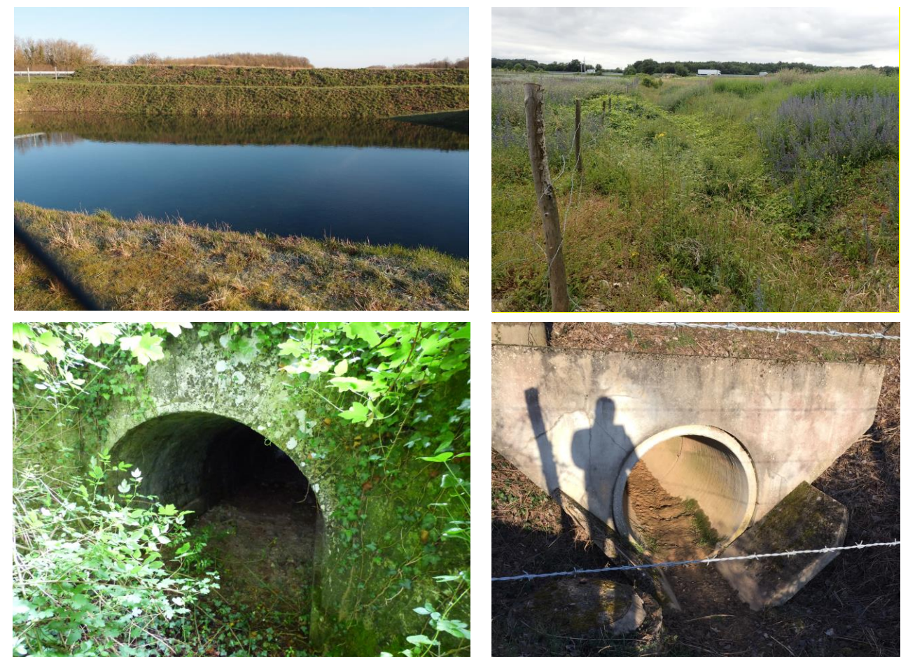
Photo 4 : ouvrages hydrauliques de la zone d'étude : bassin de rétention des eaux, fossé et busages
